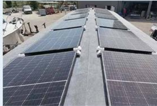
12 panneaux photovoltaïques 335 W - 4 500 W BATTERIES lithium 1490 A
